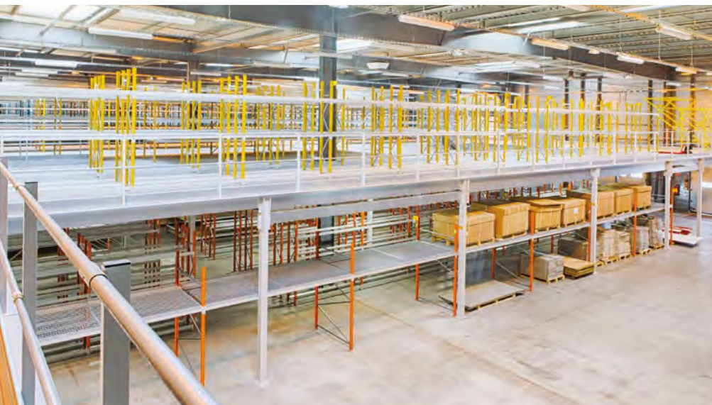
Aménagement complet d'un entrepôt logistique de pièces détachées automobiles d'une surface de 4 000 m 2 , avec des rayonnages installés sur et sous la plateforme (Spade Equipment)
